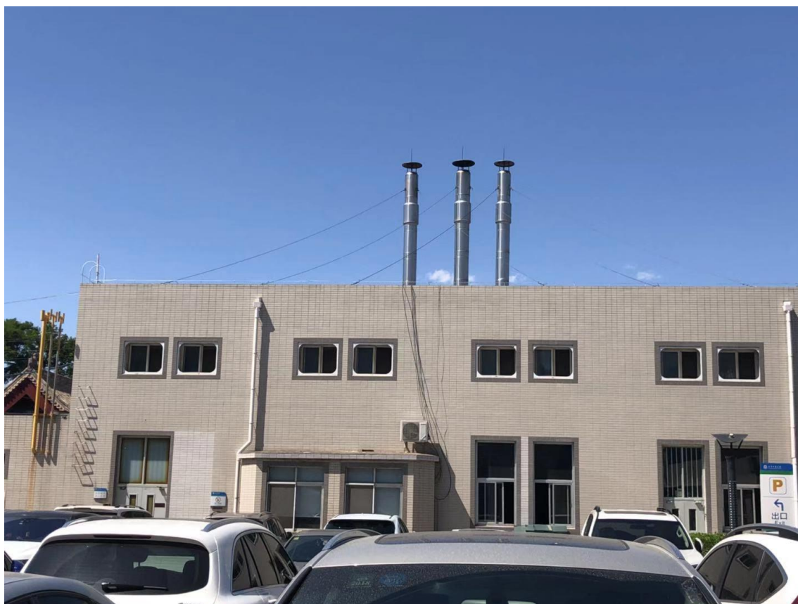
图 3.2-2 现状北京胸科医院燃气锅炉房
